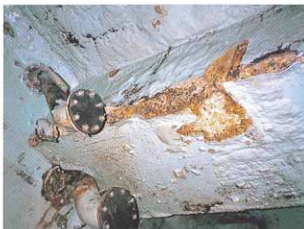
補修前の槽内面
